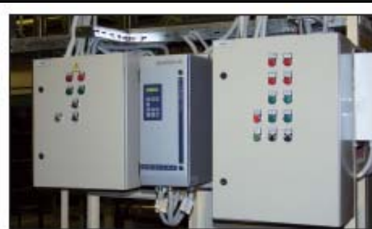
Рис. 8.14. Инвертор и комбинированные щиты управления
