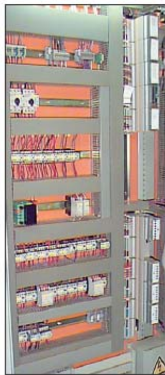
Рис. 8.5. Комбинированный щит автоматики и управления (в левой части — пусковая аппаратура, в правой — оборудование автоматики)
