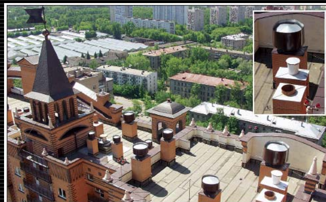
Рис. 4.1. Вытяжные крышные вентиляторы и дефлекторы на кровле здания в Тепличном пер.
